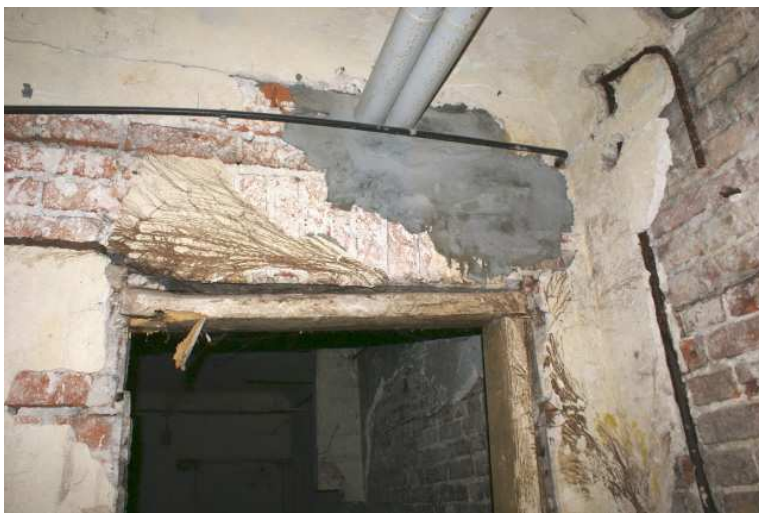
Rys. 1. Sznury grzybni grzyba piwnicznego i uszkodzony fragment ościeżnicy
