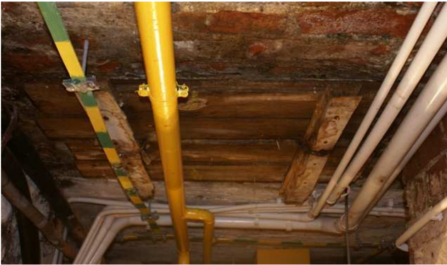
Rys. 6. Nieszczelne miejsce zabetonowania otworu w płycie stropowej pod podwórkiem
