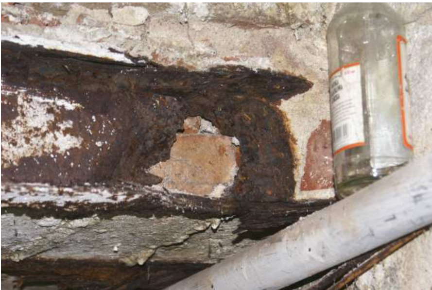
Rys. 3. Korozja belek nadprożowych w piwnicy
