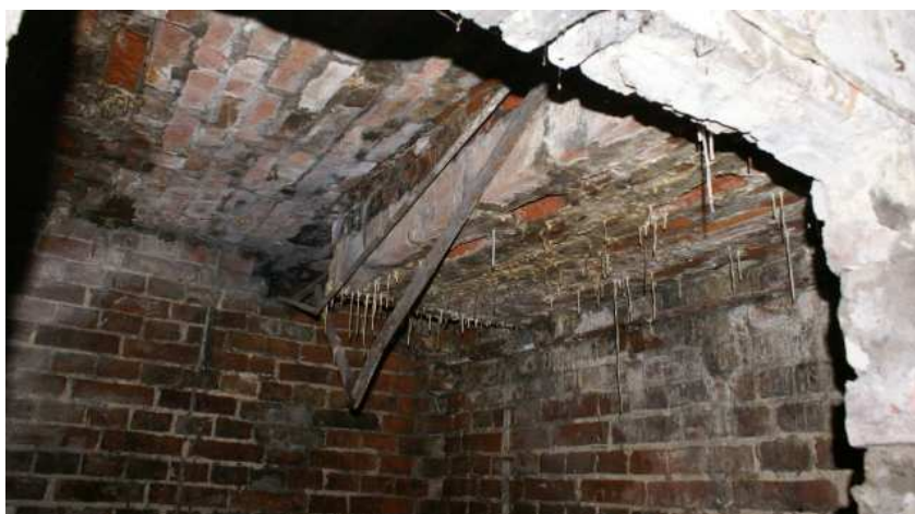
Rys. 5. Ślady przecieków przez płytę stropową nad piwnicą w obszarze podwórka
