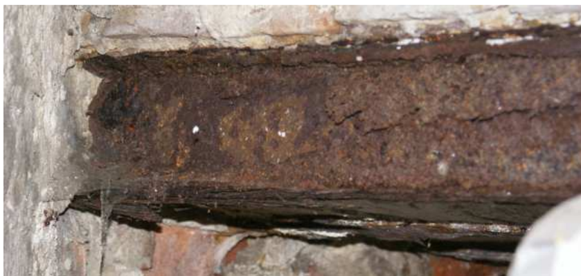
Rys. 4. Inny przykład stanu stalowych belek nadprożowych w piwnicy
