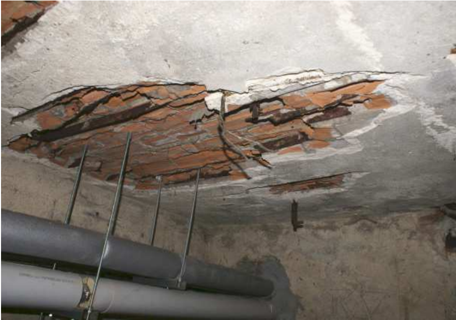
Rys. 2. Fragment stropu Kleina nad piwnicą. Odpadła spodnia warstwa cegieł i część skorodowanej bednarki
